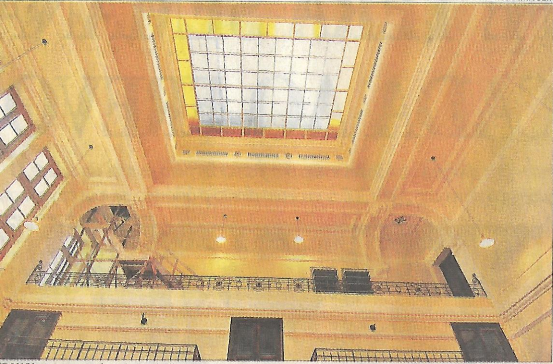
DANÇA A primeira fase dos trabalhos, que inclui a recuperação do forro e telhado, deve ficar pronta este mês
